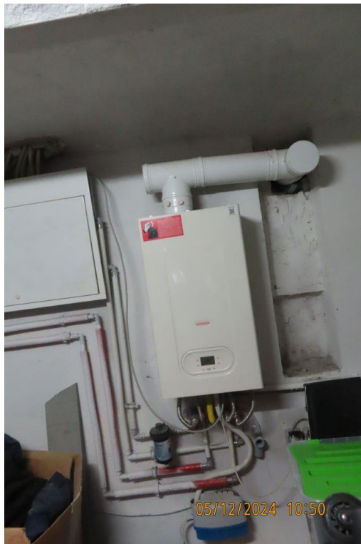
Abb. 21: Gaszentralheizung mit Fußbodenheizungsverteiler
